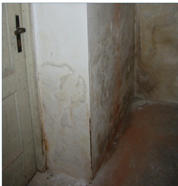
Abb. 11: Feuchteschaden im Keller mit Salzausblühungen und Schimmel durch aufsteigende und kondensierende Feuchtigkeit.
