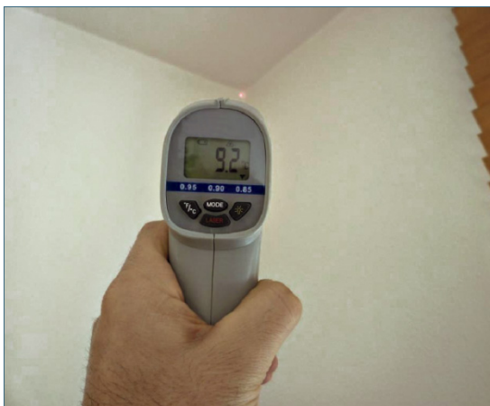
Abb. 3: Messung der Oberflächentemperatur einer Außenmauerecke in einem Gebäude aus ungedämmtem Mauerwerk mit 36-cm-Hochlochziegeln (Baujahr 1999). Bei einer Temperatur von 9,2 °C kann sich schon bei weniger als 40 % relativer Luftfeuchte und 23 °C Lufttemperatur Tauwasser abscheiden und Schimmel bilden.
