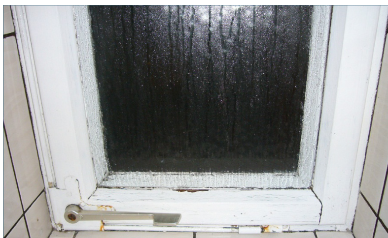
Abb. 14: Kondenswasser an einem alten Badfenster mit Schimmel in den Fliesenfugen und Feuchteschäden an Holz und Metallbeschlägen.
