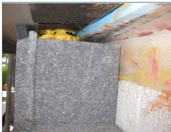
Abb. 21: Besonders wichtig ist gerade im Sanierungsfall das wärmebrückenfreie Ausschäumen der Hohlräume zwischen Fensterblech und Mauerwerk (hier unvollständig ausgeführt).
